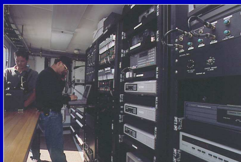
MSRC移動通信設備の内部
