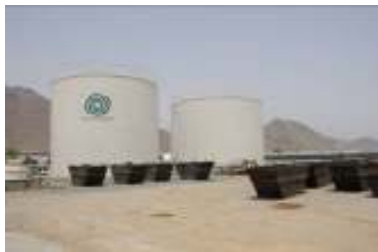
保持タンクと大型容器置場
