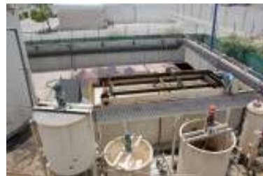
油水分離プラント
